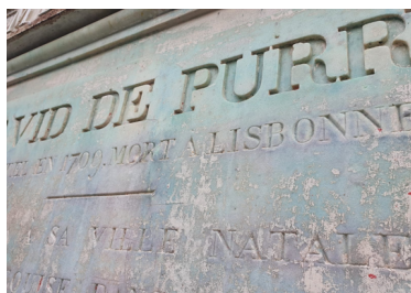
Fig.2 : Vue sur la lixiviation des produits de corrosion dans le socle. ©He Arc/UniNE, 2020.
